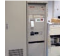
堤体観測装置
