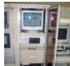
堤体観測装置
